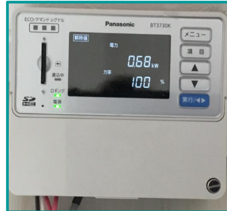
試験器PANASONIC エネミエールS 測定負荷40度設定 コントロール作動時 (電気量0.68KW)
